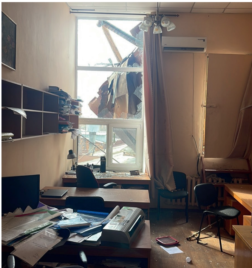
II. 5. Państwowy Uniwersytet Biotechnologii – budynek po ataku raketowym. Fot. Serhij Oleksandrowycz Panczenko
